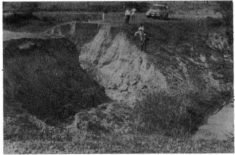
写真9 決壊した貯水ダム（'98年造成）
